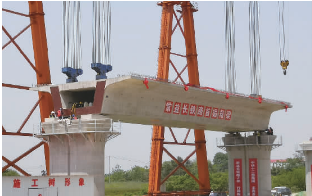
重828吨的首榀箱梁架设完成,常益长铁路开始桥梁上部结构施工。通讯员 供图
