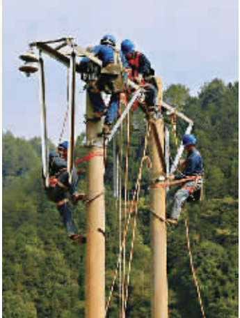
在永州电网建设项目现场,工人正在进行现场施工。受访者供图
