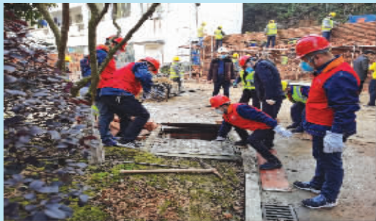
1月27日,国网长沙城北客服中心捞刀河供电所全力保障长沙市第一医院北院战“疫”电力供应。
