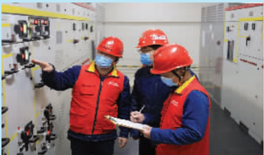
3月13日,国网长沙客服中心员工在湘江新区步步高梅溪湖新天地配电间检查用电设备,助力企业复工复产。(邓梁)
