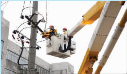
2月11日,国网宁乡市供电公司开展带电抢修,保障防疫定点医院安全供电。(苏雷一听)
