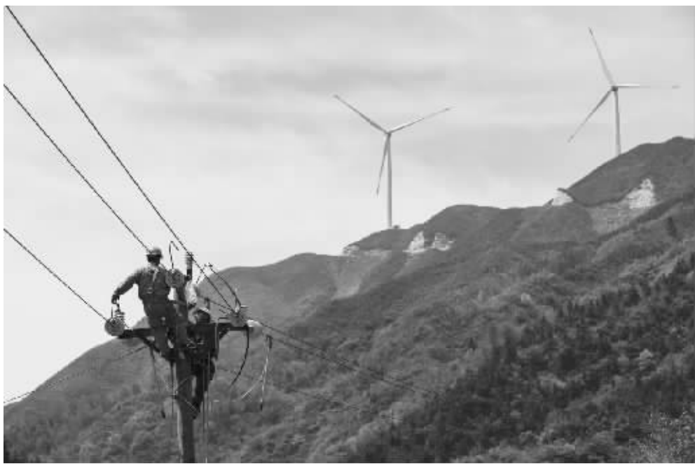
4月19日，国网桂阳县供电公司员工在贫困山区白水瑶族乡开展10千伏白洋线路综合整治施工。 ■摄影报道 周敬东 谭倩
