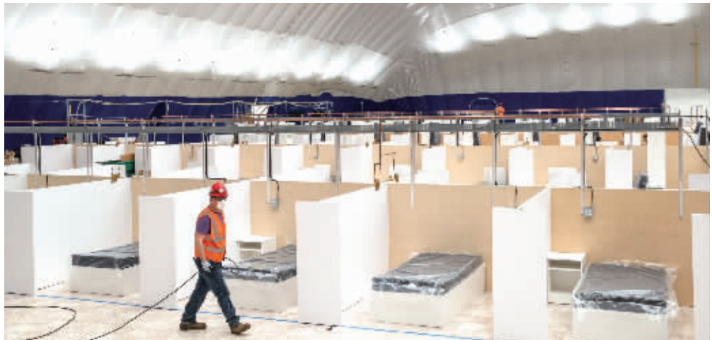
4月12日,在美国纽约,一名工人在哥伦比亚大学体育馆内参与临时医院改造工程。新华社图
