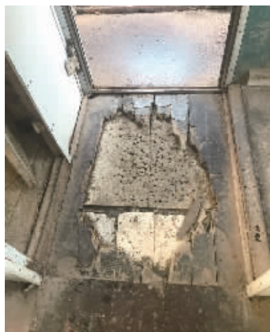
公园旧火车上部分地板被损坏。
