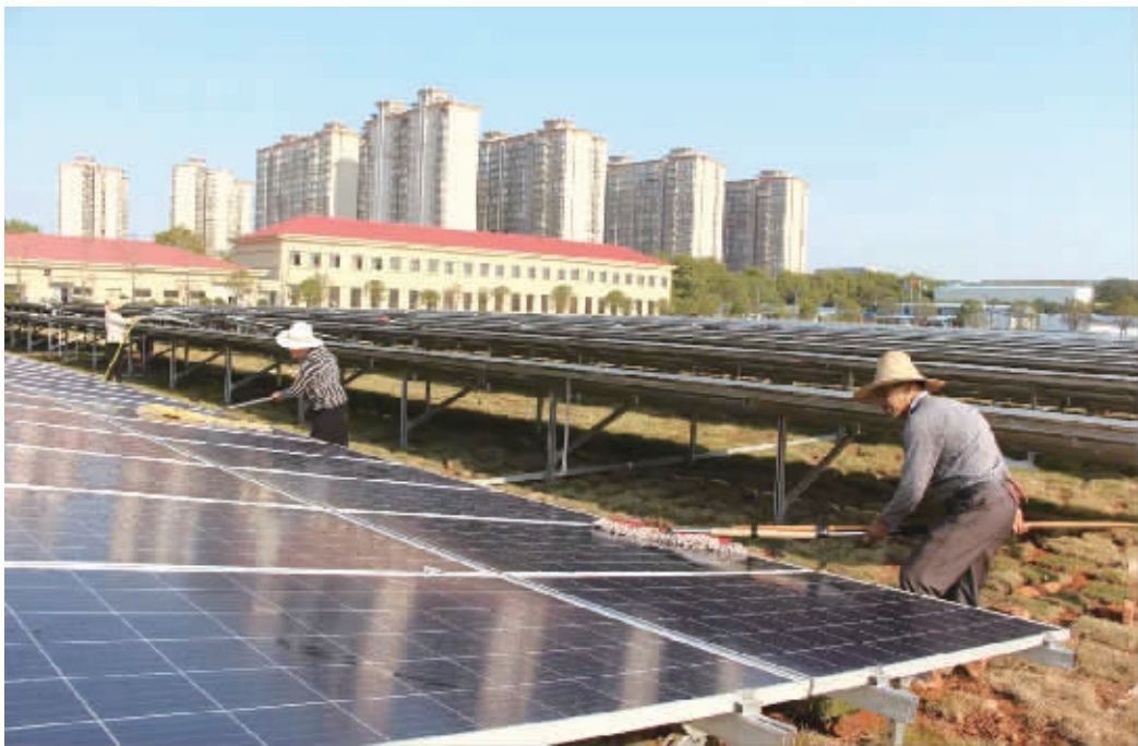
日前,在建的长沙市第七水厂,工作人员正安装光伏发电设备。 记者 李成辉 摄
