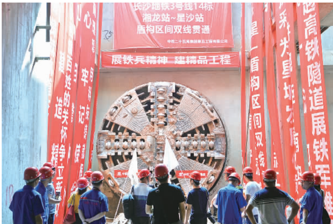
9月15日上午,随着盾构机刀盘破桩而出,标志着湘龙站-星沙站盾构区间隧道双线顺利洞通。 记者 李健 通讯员 齐绍安 摄
