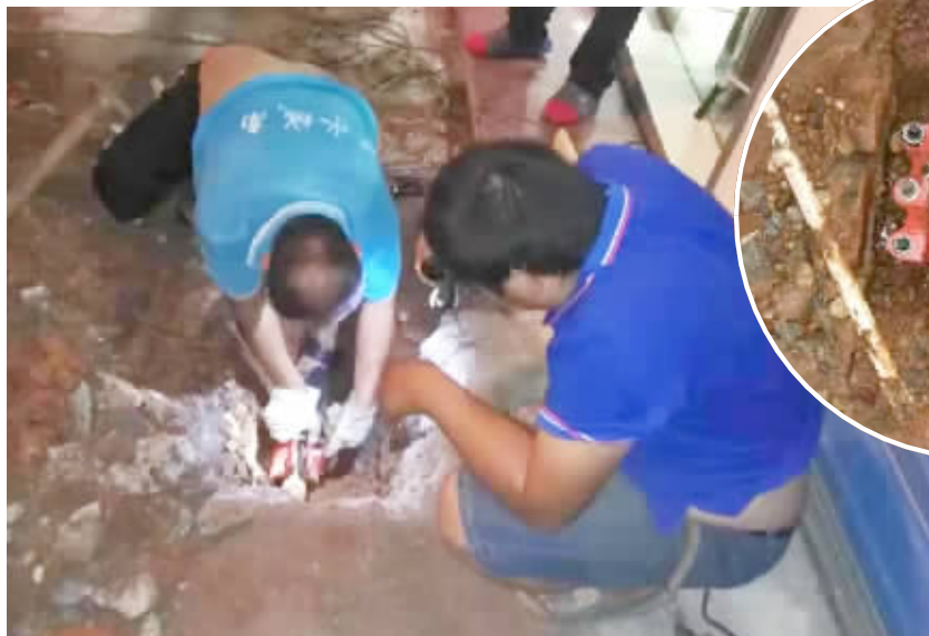
日前，长沙市天心游路9号居民楼水管破裂，供水公司抢修员紧急抢修。 通讯员 供图
