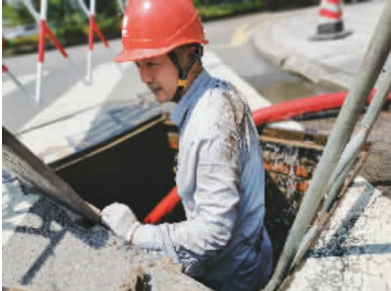
7月29日，电力工人王怒在电缆井中进行电力检修。 记者 石芳宇 摄
