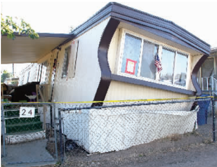
这是7月4日在美国加州里奇克雷斯特拍摄的一处被地震损坏的房屋。
