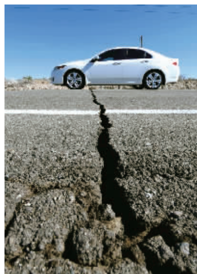
在加州特罗纳附近拍摄的一处被地震损坏的道路。 新华社图
