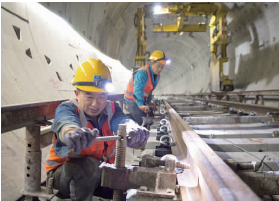
2月22日，长沙地铁5号线白茅铺站，工人正在进行铺轨施工。目前，长沙地铁5号线一期(时代阳光大道至蟠龙路)18个车站主体已完工，进入附属结构(地铁出入口、风亭、铺轨)施工阶段，有望今年6月实现全线洞通，年底实现轨通。 记者 陈月红 傅聪 摄
