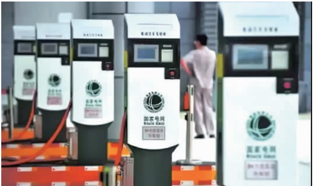
高速公路上服务区内的充电桩。据统计，我省高速公路共有10个服务区建有充电设施。记者 和婷婷 摄
