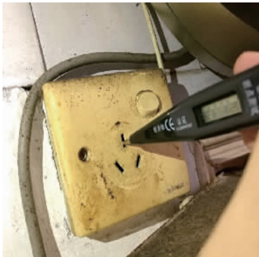
优迅电器有限公司用电笔进行了漏电检测,发现浴室插座地线带有220伏的强电。
