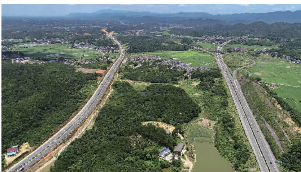
6月28日,浏阳市洞阳镇,建设中的金阳大道(左)和长浏高速(右)犹如两条俯卧大地的巨龙。金阳大道是浏阳连接长沙核心城区的一条不收费快速通道,全长43.9公里,预计2020年全线建成通车。
