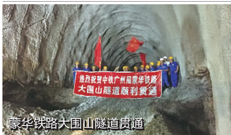
6月20日10时38分，国内最长运煤专线——蒙华铁路（北起内蒙古古勒报吉站，终点到达江西省吉安市）浏阳大围山隧道顺利贯通。大围山隧道起于浏阳市张坊镇，止于江西省铜鼓县排埠镇，全长8172米。 董小欧 贺双江 摄影报道
