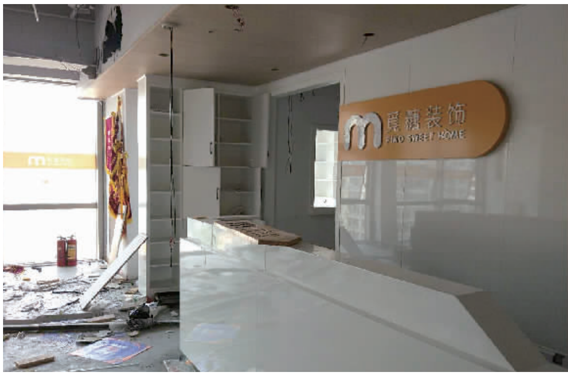
5月30日，长沙岳麓区奥克斯广场环球中心A座，觅糖装饰设计有限公司已“人去楼空”，现场一片狼藉。 记者 卜岚 摄
