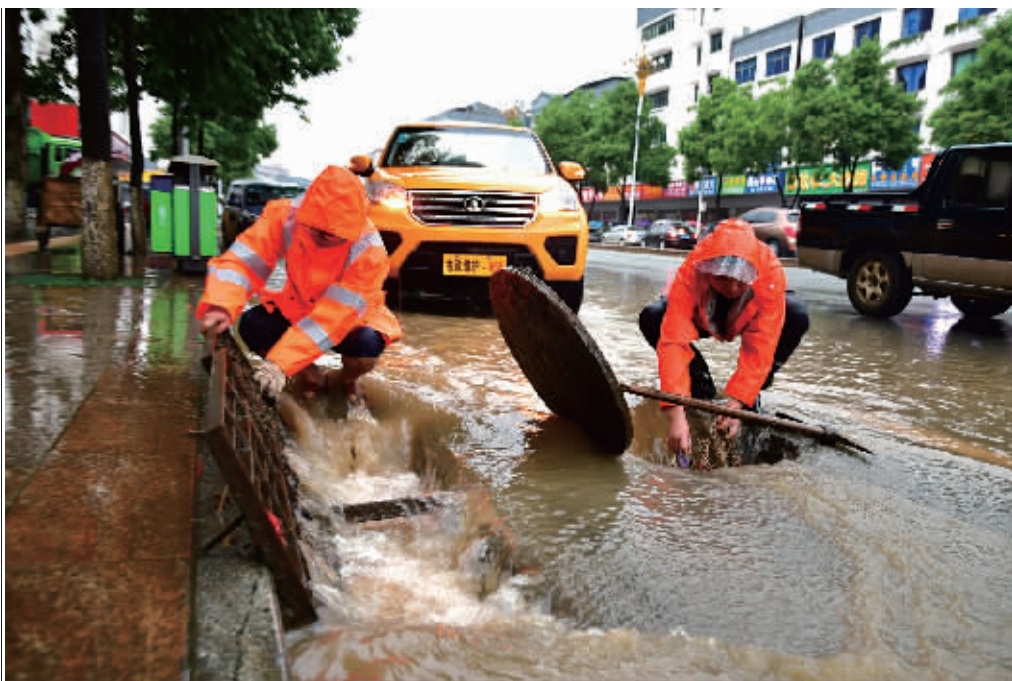
5月30日，怀化市迎丰东路石门段，市政人员冒雨打开窨井口，排除路面积水。当天，受强降雨影响，该市城区部分路段出现积水，市政人员逐一打开积水路段的窨井口，排除积水，并在每一个窨井旁安排专人看守，守护过往行人安全。 陈湘清 摄
