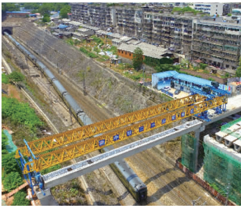
5月16日,中铁二十五局集团长沙市曙光路(车站路-雅塘冲路)项目部施工现场,一趟列车从已安装好的跨京广铁路桥首梁下穿过。当天上午,一个40米长、重150吨的箱梁成功架设在项目跨京广铁路辅道桥2#墩上并完成安装。标志着首梁架设成功,该项目正式进入跨既有架架设施工阶段。
