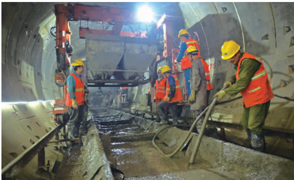
4月30日,长沙地铁4号线一期工程河西段,工人在对轨道道床进行浇筑施工。当天,该地铁4号线一期工程河西段顺利实现双线“轨通”。长沙地铁4号线一期工程河西段全长18.3千米,预计最早年底建成通车。记者 李健 摄
