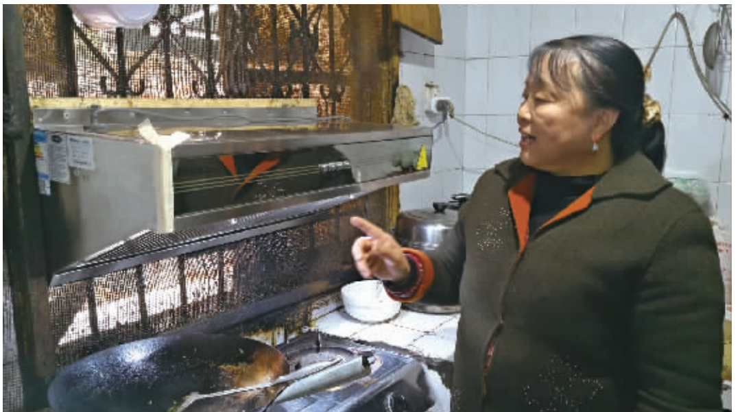
3月20日,长沙县星沙街道凉塘路社区,居民向记者介绍新安装的环保油烟净化机的使用功能。记者 丁鹏志 摄
