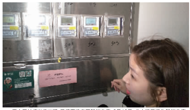
天心区长盛岗庭二期，已经更换完了智能电表。3月16日，业主演示操作智能电表，“可以查每月用电量，加装大功率电器也不怕了！” 记者 李成辉 摄
