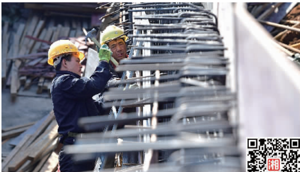
2月6日上午，长沙县东四线综合管廊项目建筑工地，工人在施工。扫二维码观看该综合管廊项目施工现场。
