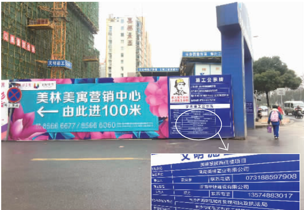
1月16日, 美林景园商住楼项目施工现场, 许可证与现场公示的围挡占道起止时间不一致。
