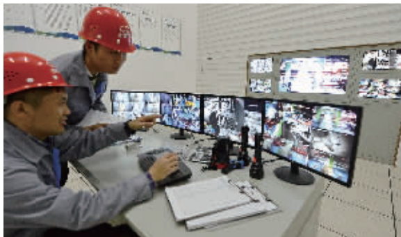
11月17日，技术人员在长沙滨江新城智慧能源中心监控供暖设备。 记者 徐行 摄
