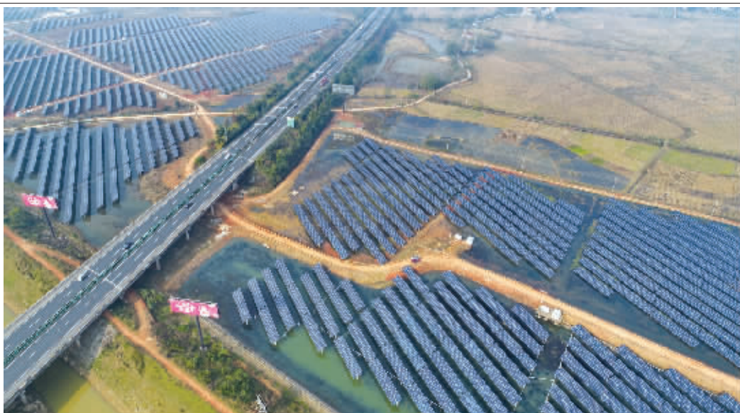
12月5日，汉寿县崔家桥镇，占地1823亩的建在水面上的中晖光伏发电建设项目。目前该项目已完成全部光伏板、电线设备安装，建成后年上网电量可达6800万千瓦。近年来，该县利用丰富的鱼塘、滩涂、芦苇荡滩等开发“渔光互补”光伏项目，发电面积1万亩以上。
