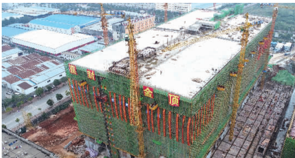
11月22日，长沙市雨花区环保科技有限公司，我省2017年重点建设项目云冷1号主体封顶。该项目将为长沙新增10万吨冷库容量，也是目前全省最大的单体冷链项目。 记者 徐行 摄
