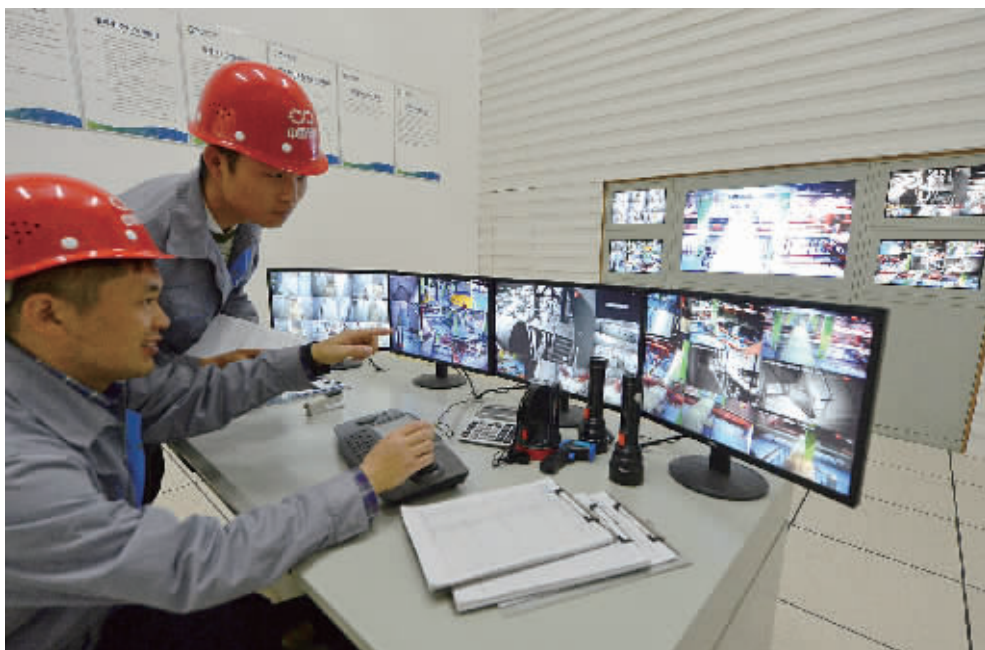
11月17日,技术人员在长沙滨江新城智慧能源中心泵房控制室内操控取水供暖设备。
