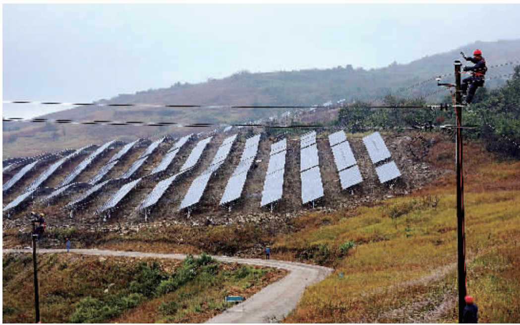
11月15日,电力工人在宁远县黑井光伏电站进行并网架线施工。目前,该县总装机容量1.714万千瓦的14个光伏电站全面完成并网线路架线,将于月底投入发电,带动全县1703户贫困户受益。 乐水旺 陈怀松 摄
