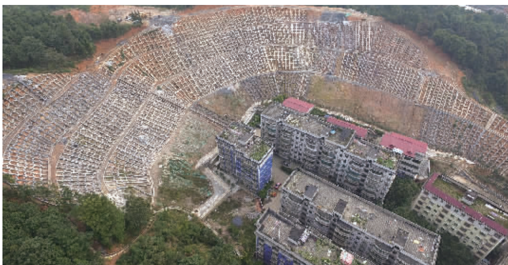
11月14日,郴州市苏仙区下里坪街道环城桥社区地质灾害隐患点,经过综合治理,穿上了坚固的“盔甲”。去年4月起,郴州市国土资源局苏仙分局投入1308万元,采用了多种施工手段进行山体加固,历时一年半,主体工程全部完工,自此,昔日的地灾险情山坡被治理成周边54户181位居民的安全港湾。李贵 黄玲 摄影报道
