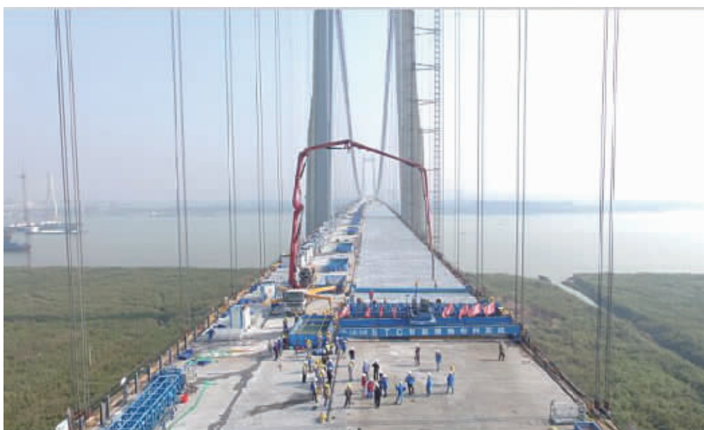
近日，岳阳洞庭湖二桥完成了超高韧性混凝土(简称STC)最后一段浇筑。和普通桥面不同，STC桥面可实现终身无需大修的超长寿命，这座世界第二、国内第一大跨径的钢桁梁悬索桥预计今年年底竣工通车。 雷谊 摄
