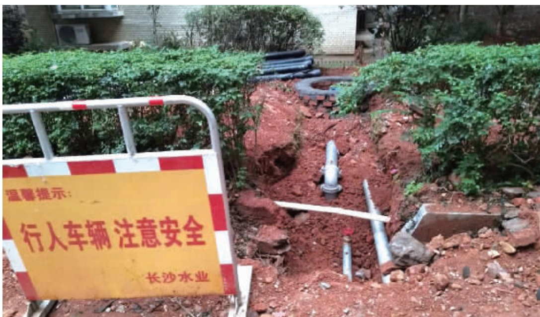
金碧文华小区内,四处都可见裸露的水管。记者 杨昱 摄
