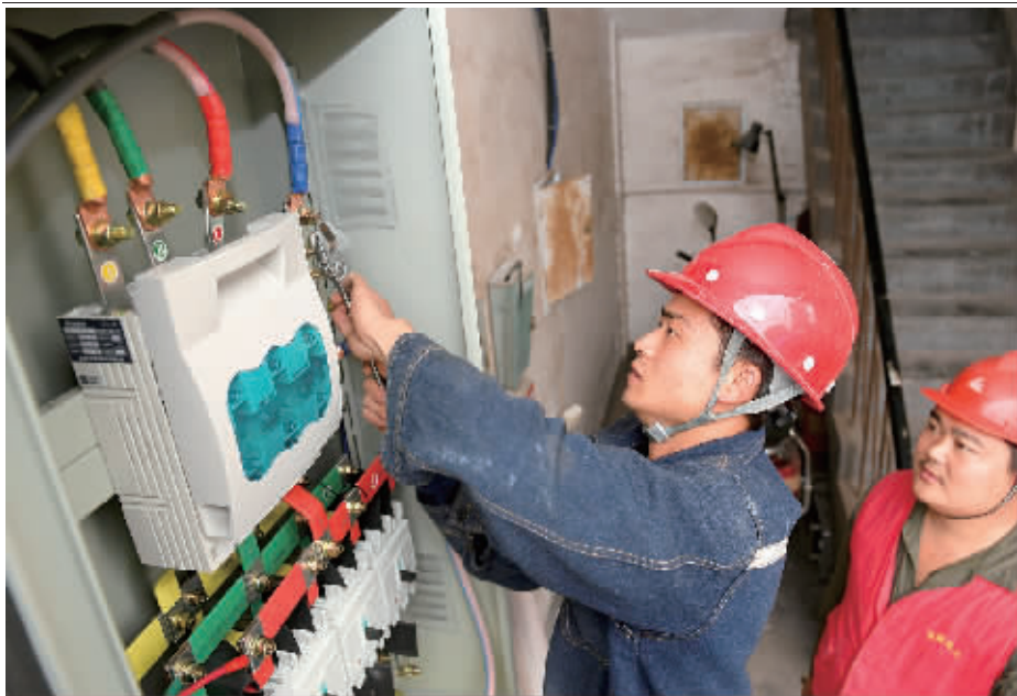
11月7日,长沙市雨花区碧翠园小区,电力工人在安装新电表。今年,长沙市统一实施电力“专改公”改造工程,为该市80个老旧小区进行配电改造。 记者 唐俊 通讯员 李嘉 摄
