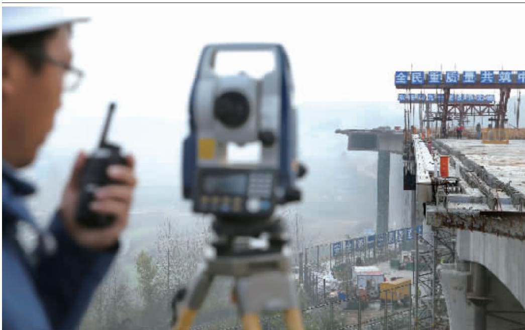
11月7日,在汉十高铁三墩转体桥施工现场,技术人员校对转体对接数据。当日,位于湖北十堰丹江口市丁家营镇境内的汉十高铁丁家营跨襄渝铁路特大桥44号墩、45号墩、46号墩连续梁分别逆时针转动,在空中实现精准对接。该特大桥跨越襄渝铁路施工段采取“先建后转”方式,确保铁路运营安全畅通。 新华社图
