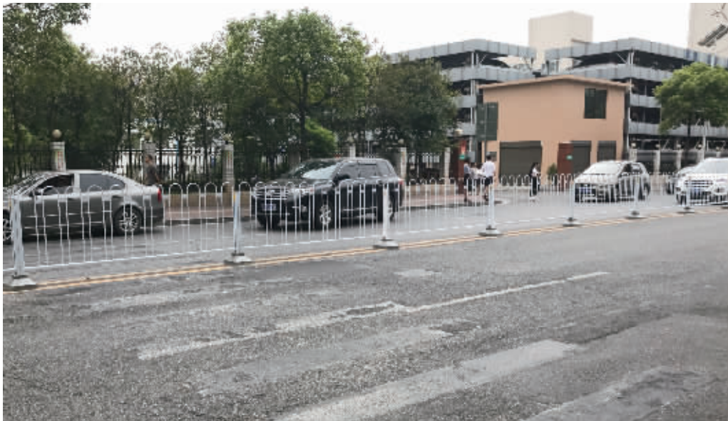
8月30日,银双路润泽府小区路段,路面仍能看到被铲除的斑马线痕迹。 记者 魏灿 实习生 杨琰 摄
