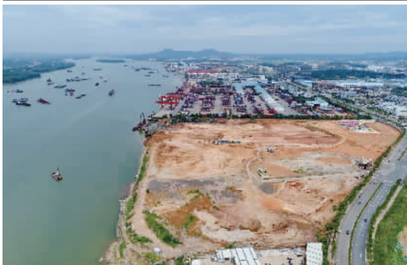
8月28日，长沙新港三期建设工地，土地平整工作已经完成。列入交通运输部“十二五”规划，湖南省、长沙市重点工程的长沙新港三期工程，将建设货运码头泊位6个，新建港区铁路专用线2.64公里，港外联络线3.1公里。
