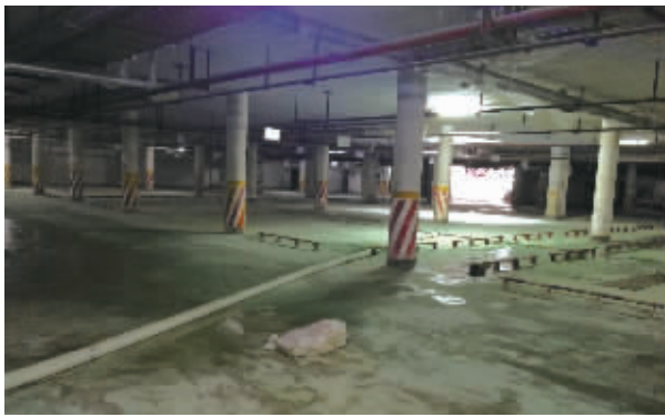
6月27日下午，长沙市开福区左岸春天小区33栋地下车库改造施工已经停止，几台吹风机正在进行排风作业。记者 丁鹏志 摄
