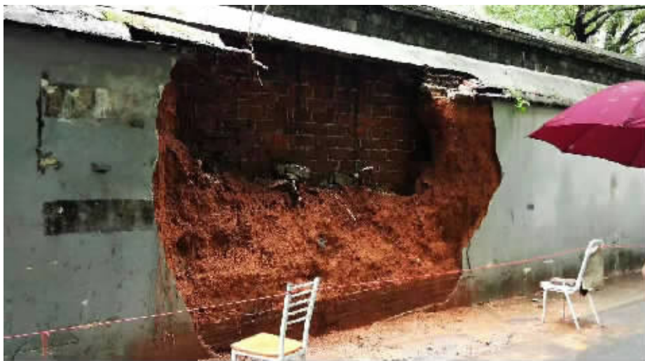
6月26日，长沙南元宫古土墙中间一节发生垮塌，坍塌的墙体旁已拉起警戒线，提醒路过市民注意。 记者 李成辉 摄
