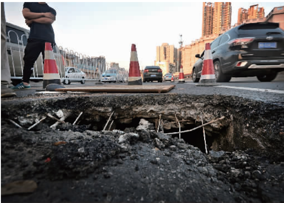
5月9日，长沙市银盆岭大桥东引桥西往东方向，桥面出现凹陷的一个深坑。 记者 李健 摄
