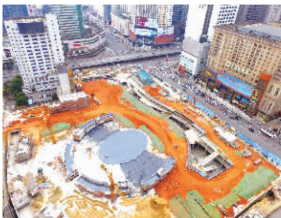
正在建设中的长沙市五一广场绿化用地地下空间项目。 记者 田超 摄
