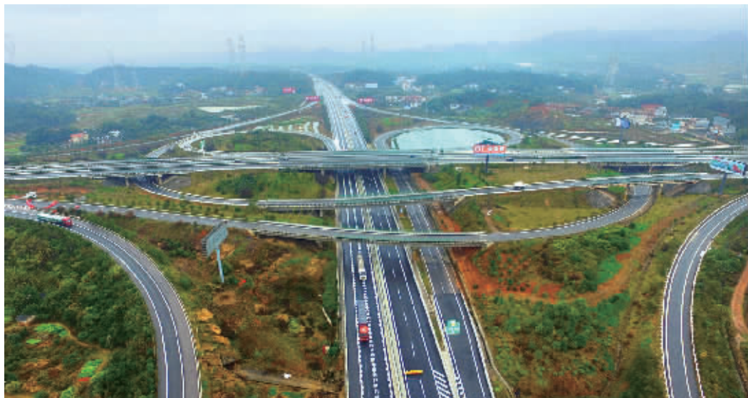
11月23日,大修后的沪昆高速潭邵段与岳临高速塔岭互通。当天,沪昆高速潭邵段大修一期工程北半幅(湘潭往娄底方向)路面施工全部完成。 记者 郭立亮 摄
