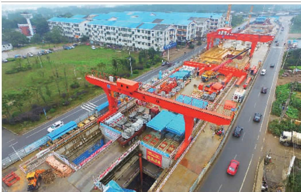
10月26日上午,俯拍长沙地铁4号线汉王陵公园站建设现场。该站主体结构于24日顺利封顶,成为地铁4号线河西段首个完成车站主体施工的站点。
