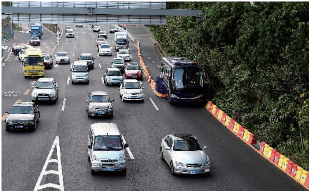
10月24日，一辆可自动“吞吐”道路隔离带的潮汐车道“拉链车”(最右)在深圳布吉路作业。新华社 图
