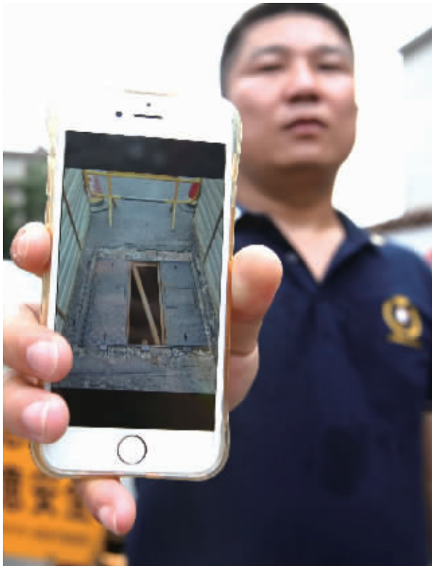
8月12日,长沙市开福区德雅路才子佳苑门口,市政局工作人员在接到热线反映后立即到现场设置警示标示,并拍照上传至微信群,通知相关责任人前来修复。 记者 赵持 摄
