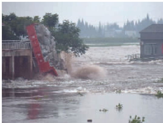
7月10日下午7时许，华容县沿河渡镇轸头湾村，华容河北堤溃坝处，在现场指挥员的指挥下，先后推送数台卡车下河，试图减缓水流及对堤坝的冲刷。 记者 童迪 唐俊 摄
