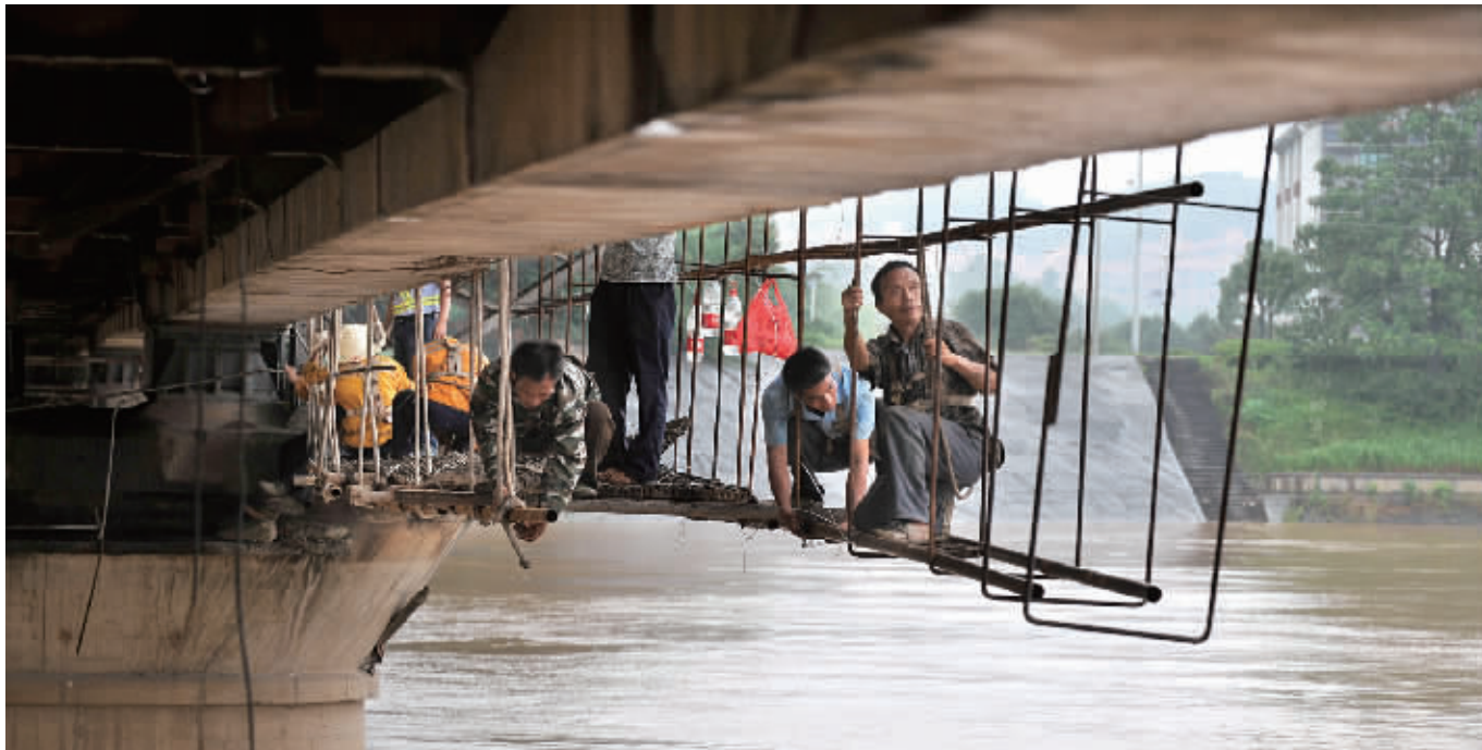
7月5日，京广线长沙市捞刀河桥，广铁集团长沙工务段组织人员搭建脚手架。7月4日20时59分，一艘货船沿河道从东往西撞上该桥第四号桥孔的桥梁，对桥梁产生了一定的损伤。目前，工作人员正对受损的桥梁部分进行检测，并将制定维修方案实施维修。
