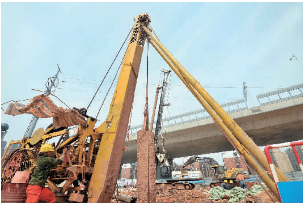
6月9日上午,长沙市地铁5号线三一大道站工地,施工人员正在进行围护结构施工。端午假期,承担该工地施工的中建五局140多名工程技术人员放弃假日休息,加班加点,抢抓施工进度及质量。该工地今年3月进场开工,4月进行实体建设,预计下月初即可进入土方开挖阶段。 记者 田超 摄影报道
