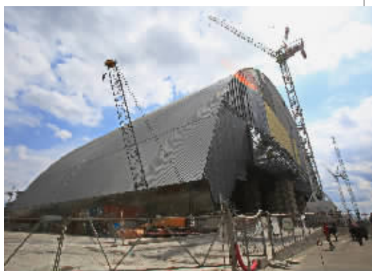
这是4月22日在乌克兰北部切尔诺贝利核电站拍摄的正在修建的拱形防护罩。
