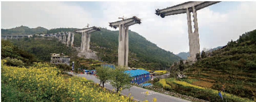
3月19日，古丈县默戎镇，施工中的永吉高速(永顺县至吉首市)第十三合同段默戎特大桥在油菜花和蓝天白云的衬托下，美丽壮观。 张术杰 摄
