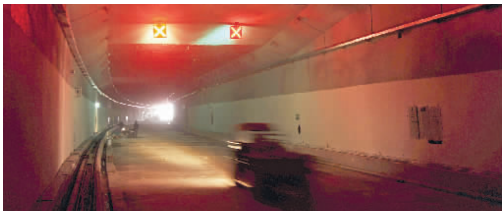
1月7日,长沙市三环线隧道施工现场,工作人员对隧道进行扫尾施工。 记者田超摄
