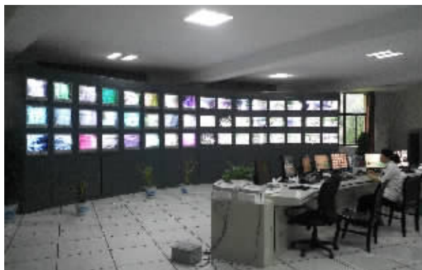
湘潭东方名苑拥有一流的监控室。
